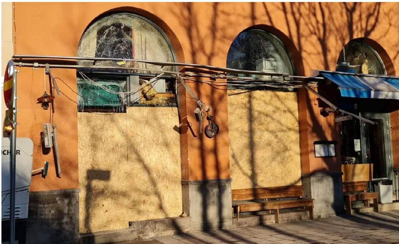
På en vanligtvis lugn gata på Söder i Stockholm detonerade en sprängladdning en vinternatt. Fastigheten fick skador som bostadsrättsföreningen fick hantera. Bild: Borätt Forum.
